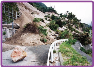
土砂くずれが起きます。 [新島・神津島近海の地震] (東京都提供)
